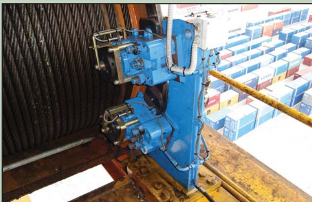
Εγκατάσταση Φρένων Κινδύνου Installation of Emergency Brakes
